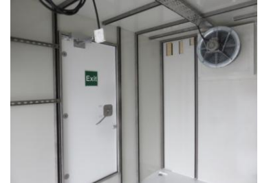
Fresh air fan and door
